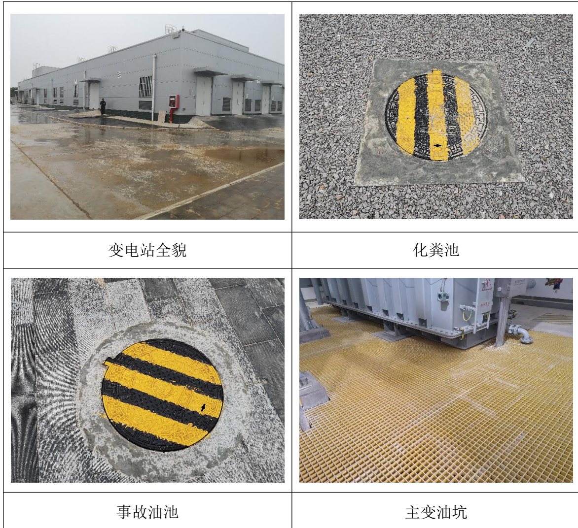
图 1-3 韩湾变站内现状
