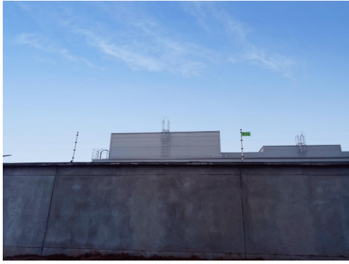
韩湾 110kV 变电站出线处
