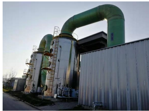
现有臭气处置装置
