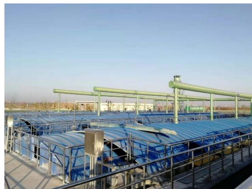
现有臭气加盖收集装置
