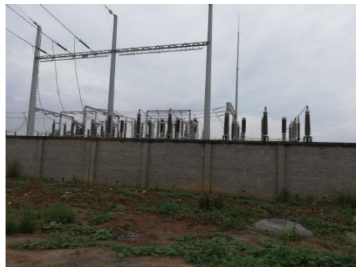
空港变电缆出线间隔
