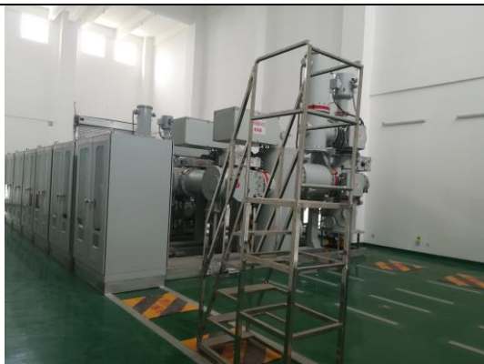
110kV GIS 设备
