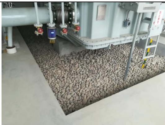
主变基础事故油坑
