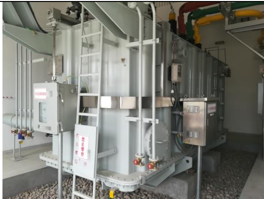
钓台 110kV 变电站 1 号主变
