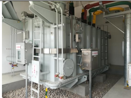
钓台 110kV 变电站 2 号主变
