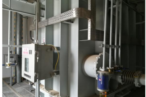
上林 110kV 变电站 3 号主变
