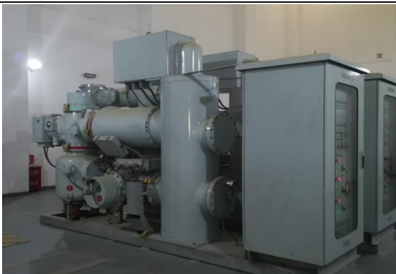
110kV GIS 成套设备
