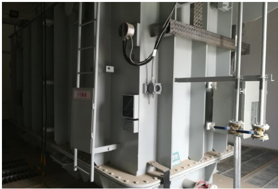
上林 110kV 变电站 2 号主变
