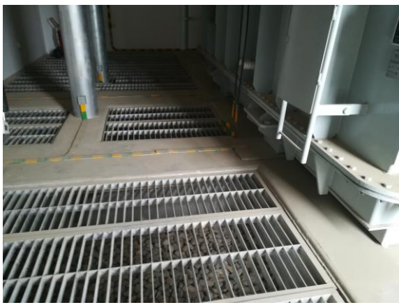
主变基础事故油坑
